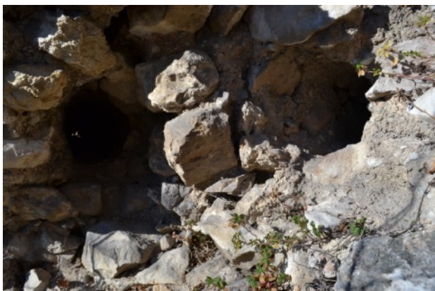
Figura 9: Castel Barco, Pomarolo (TN). Sezione della cinta sommitale con le tracce lasciate dal sistema di rinforzo ligneo con travi a sezione circolare. Particolare.
