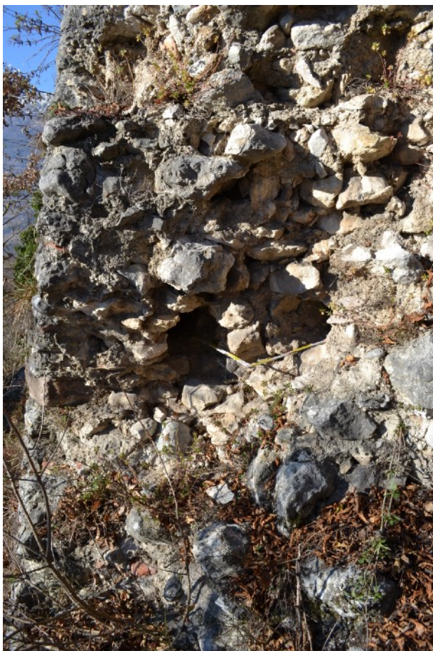
Figura 8: Castel Barco, Pomarolo (TN). Sezione della cinta sommitale con le tracce lasciate dal sistema di rinforzo ligneo con travi a sezione circolare.
