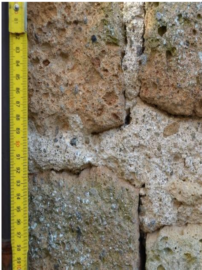
Figura 11: La malta di connesura presenta macroscopicamente una matrice chiara, tono caldo, con calcinarioli e aggregati di dimensioni anche molto varie interpretabili, in prima analisi, come frammenti di Ignimbrite ed elementi a comportamento pozzolanico che si possono cogliere anche nelle tasche dei contigui blocchi di Ignimbrite.
