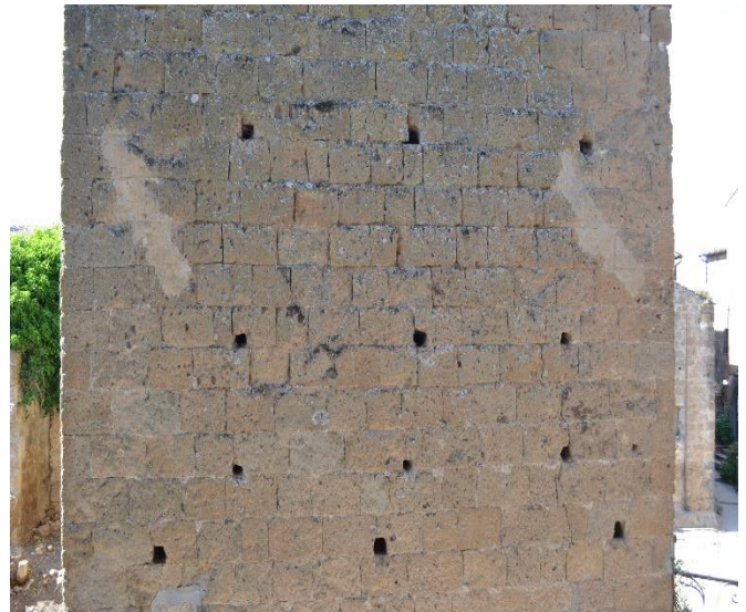
Figura 22: Torre dell'ex. Palazzo Comunale. Tracce del paletto non più esistente degli incatenamenti interni in corrispondenza del primo livello.
