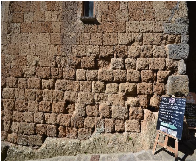
Figura 19: Il degrado degli elementi a quota inferiore, ammassati con conci di leucite tefritica squadrati, spianati a punta e con nastrino perimetrale a scalpello piano, suggeriscono il crollo e la ricostruzione di questo edificio, forse contestuale ad un evento sismico. L'analisi degli elementi architettonici e di ulteriori indicatori cronologici permetterà di confermare eventualmente le ipotesi formulate.
