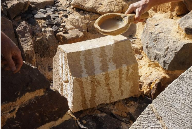
Figure 15: Humidification d'un claveau, destinée à assurer une bonne prise en main (en éliminant la poussière) et une bonne prise du mortier. © Guédelon
