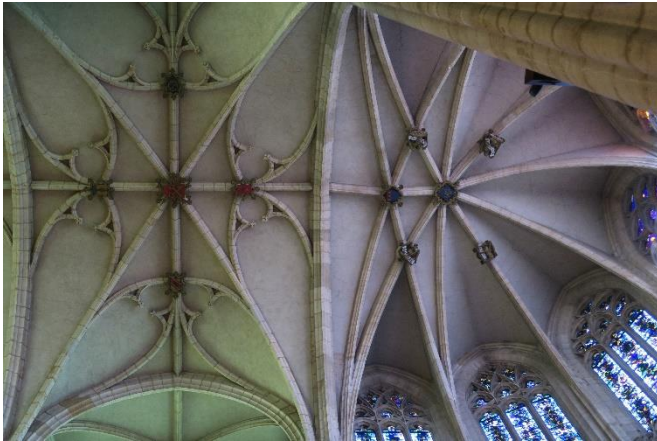
Figure 4: Saint-Nizier de Lyon, voûtes de l'abside et du chœur (fin XVe): un défaut d'implantation dans le pan sud de l'abside a occasionné un gauchissement vers le sud de la clef de la voûte, gauchissement mis en évidence visuellement par le lierne. Cliché N. Reveyron.
