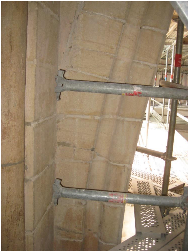
Figure 1: Cathédrale de Lyon, tas de charge dans les voûtes sexpartites de la nef centrale (ogive centrale). Le tas de charge atteint ici une hauteur considérable de quelque 2 m. Cliché N. Reveyron.
