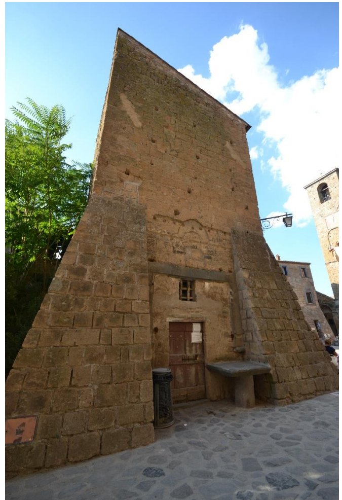
Figura 20: Presidi antisismici angolari dell'Ex Palazzo Comunale, complesso architettonico molto trasformato e caratterizzato da un parziale stato di rudere.
