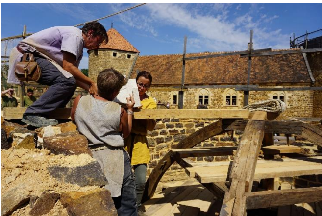
Figure 11: Réception de la clef de voûte. Le bloc est déposé par-dessus le mur, sur un long bastaing, puis sera tiré par glissement jusqu'à son emplacement. © Guédelon
