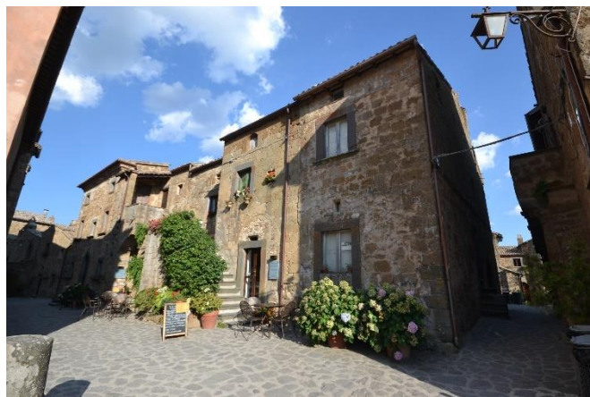
Figura 15: Complesso Architettonico campione, sul quale si sono svolte indagini più approfondite: rilievo materico, costruttivo, stratigrafico, del degrado e del danno. Vista nord-ovest.
